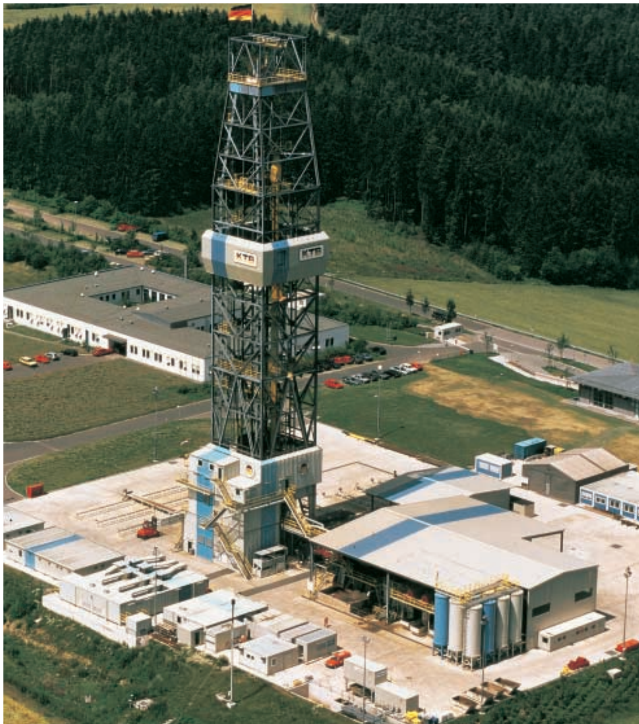
1. LES INSTALLATIONS du forage principal KTB, près de Windischeschenbach, en Allemagne. Dans le grand bâtiment situé à droite de la tour de forage se trouve la station de traitement des fluides de forage. En bas à droite, les conteneurs bleus et blancs protègent les installations de mesure, tel un treuil fixe équipé d'un câble d'une longueur de dix kilomètres, au bout duquel des sondes de mesures sont
