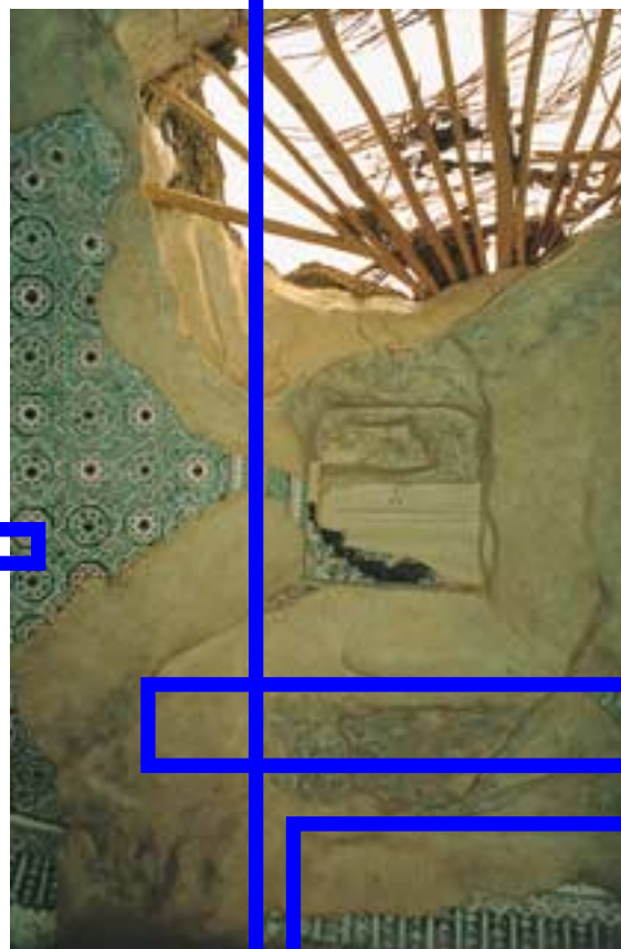
6. LE PLAFOND effondré de la grotte 460 montre la fragilité des monuments de Dunhuang. Le plafond a été progressivement aminci par l'érosion dans nombre d'entre elles.
