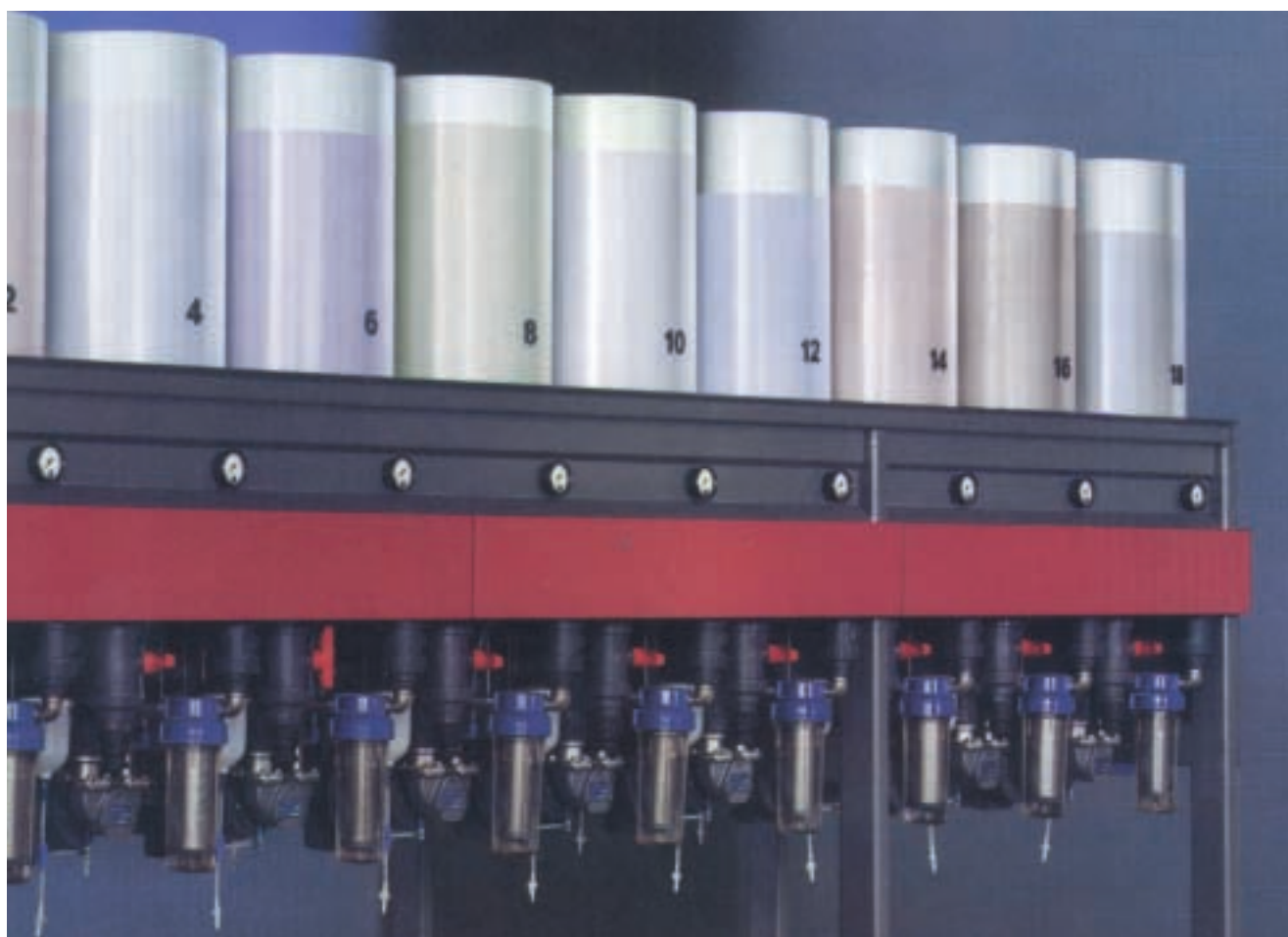
1. INSTALLATIONS D'ENNOBLISSEMENT. La machine en haut à gauche est une «barque» de teinture (1885). À sa droite figure un vaporeur moderne et, en bas, une machine à mélanger les couleurs.
