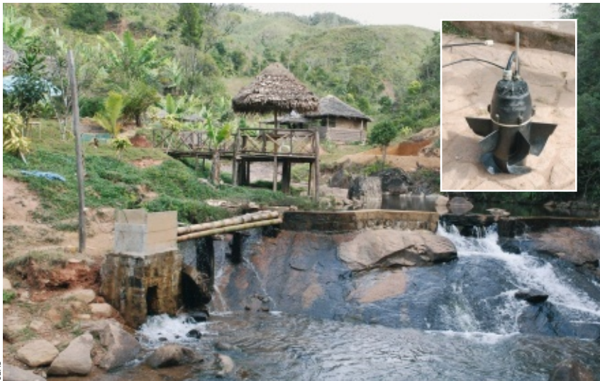
UNE PICOCENTRALE HYDROÉLECTRIQUE installée sur une petite chute d'eau (au premier plan à gauche). Le générateur (voir le cartouche) fournit quelque 400 watts, de quoi améliorer le quotidien de plusieurs foyers.
