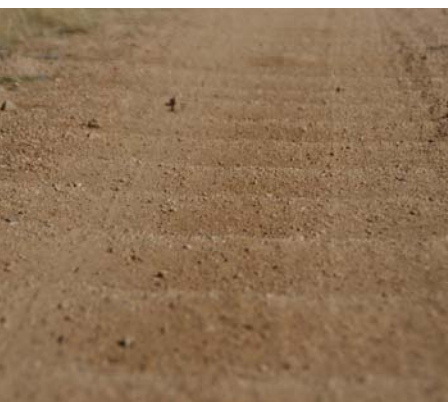
Une piste déformée en tôle ondulée, en Mongolie.
